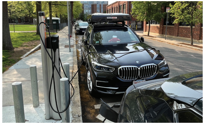
Estação de recarga de veículos elétricos na 29 Tudor Street.
